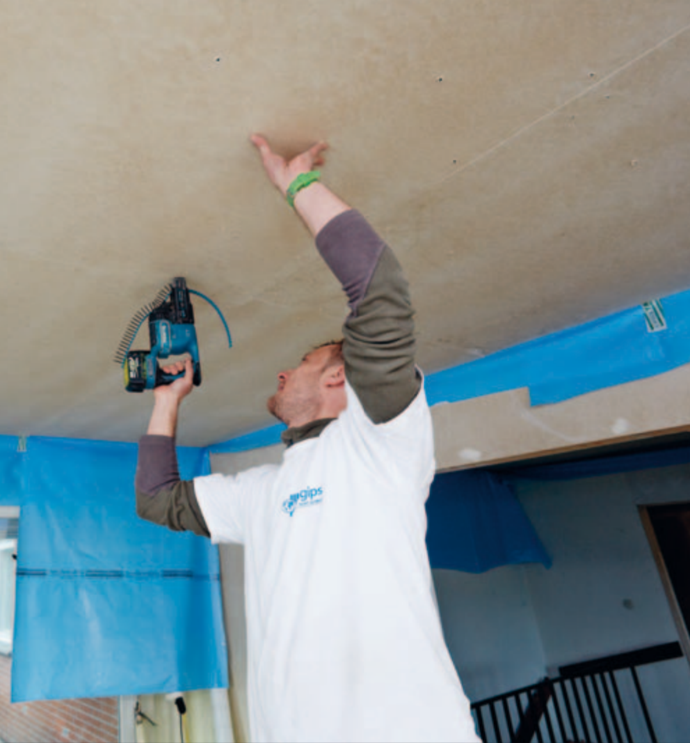
Belastete Spanplatten sollten ausgetauscht und durch Massivholz, Gipsfaser- oder Gipsplatten ersetzt werden.
